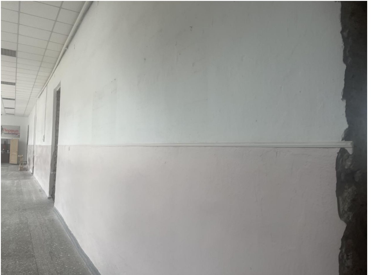
Школьный коридор до замены дверей и покраски стен.
